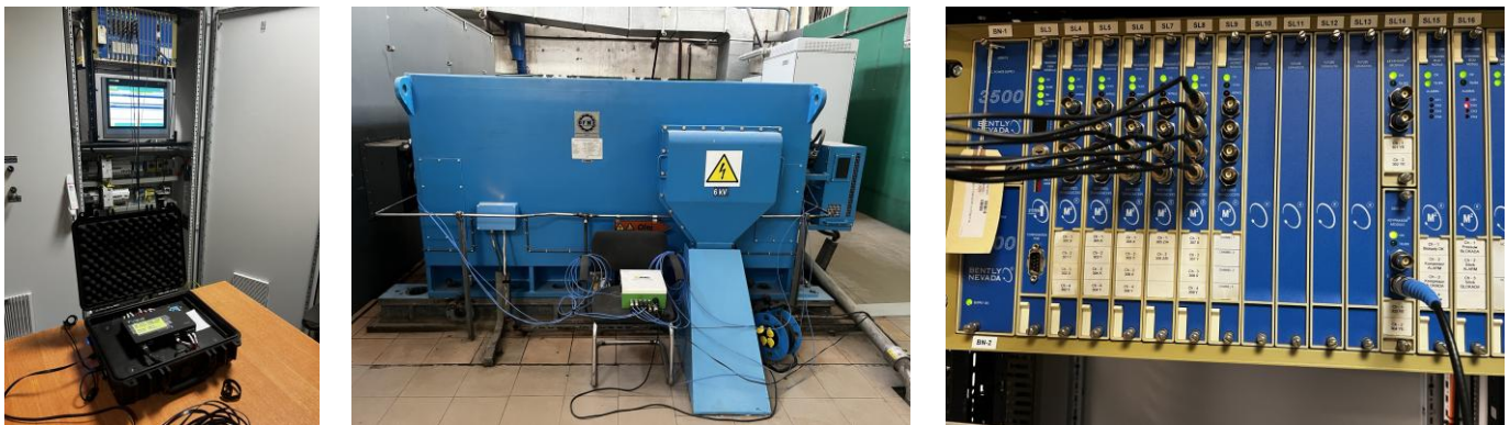
Figure 1. TWave w walizce pomiarowej, mobilny zestaw przy silniku oraz pobór sygnałów z wyjść buforowanych Bently Nevada 3500. Zdjęcia z realizacji pomiarów VIMS.
